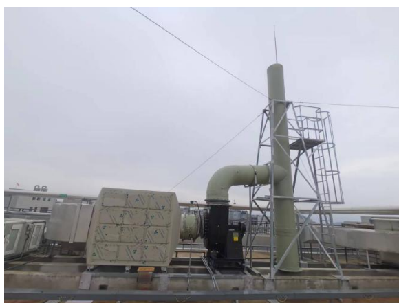
QC质检楼废气处理设施
