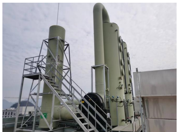
发酵废气处理设施
