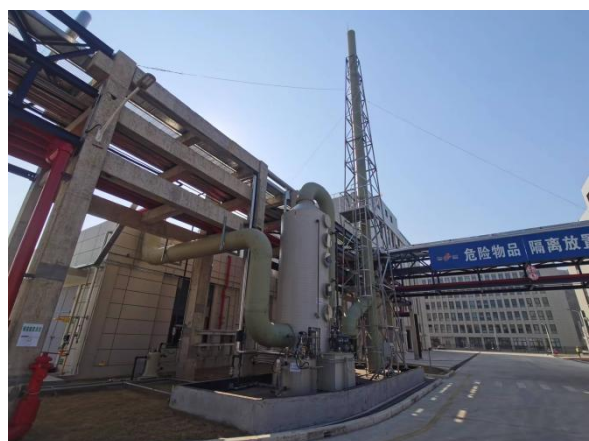
固光仓库废气处理设施
