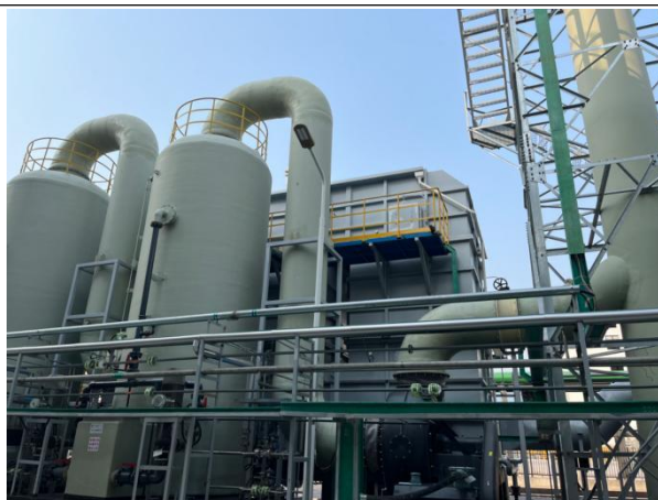
RTO废气处理设施
