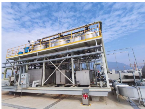
4车间大孔树脂吸附预处理装置
