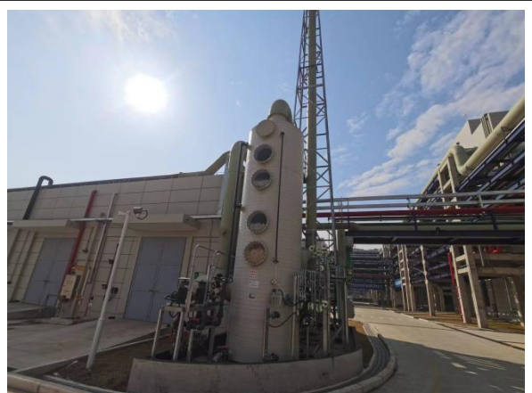
固废仓库废气处理设施
