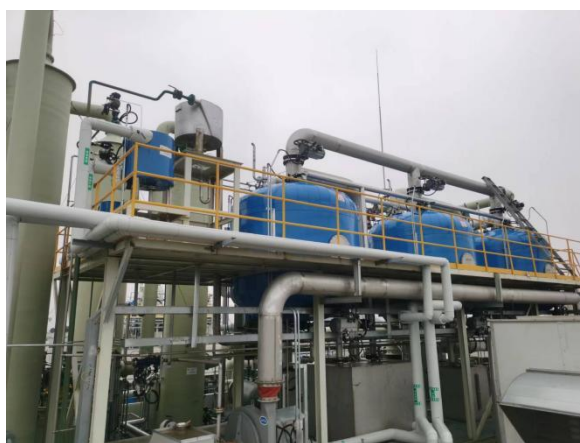
3车间大孔树脂吸附预处理装置
