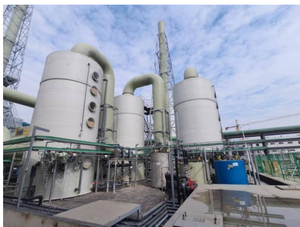
污水站、车间低浓废气处理设施
