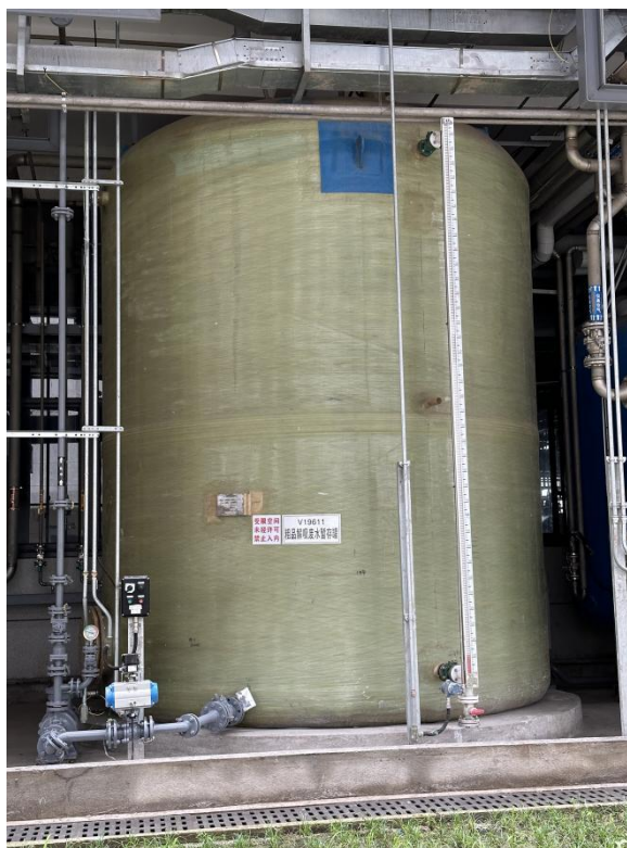
车间高浓废水地上罐
