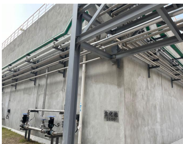
综合废水处理站
